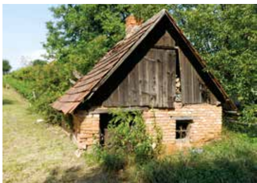
Dubňany, chátrající původní sklep
